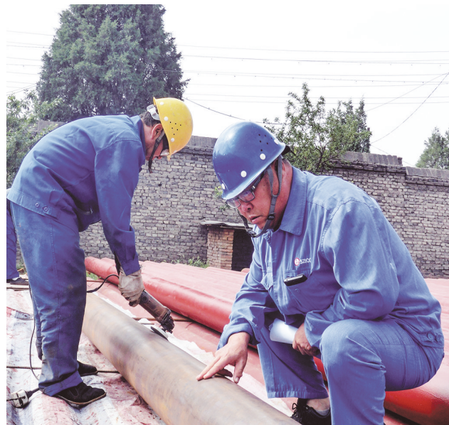
图为监理人员正在对施工人员进行管网除锈情况认真检查。 闫慧娟 摄
