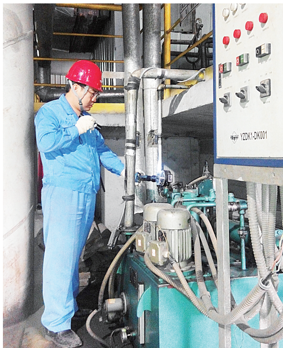
加工厂超细粉作业区积极加强设备管理,组织全员坚持每天对设备进行点检和巡检,对设备隐患早发现、早计划、早整改,全面确保设备正常运转。图为职工正在对设备运行情况进行检查。李美胜 摄
