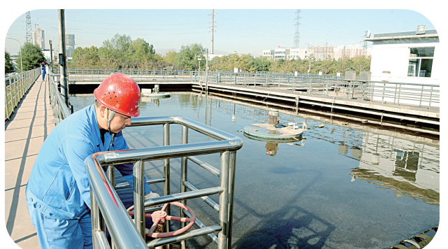
生活污水处理系统
