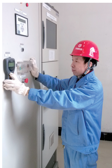
王刚 能源动力总厂电调作业区远动组组长
