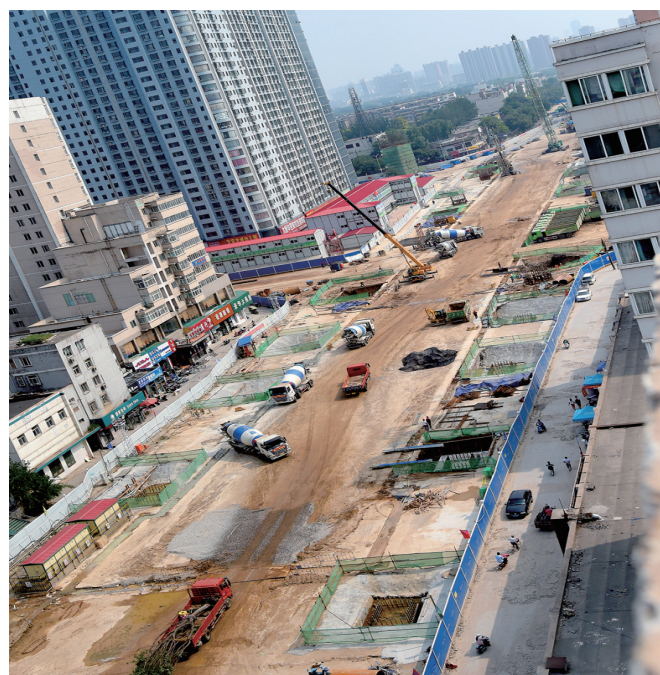
8月10日,太原市尖草坪立交桥改造工程正按计划节点紧张进行。在工程建设人员的共同努力下,截至目前,一期工程承台完成19个,钢构件加工完成6000吨,南北方向恒山路至涧河路段将于今年年底前完工。王旭宏 摄
