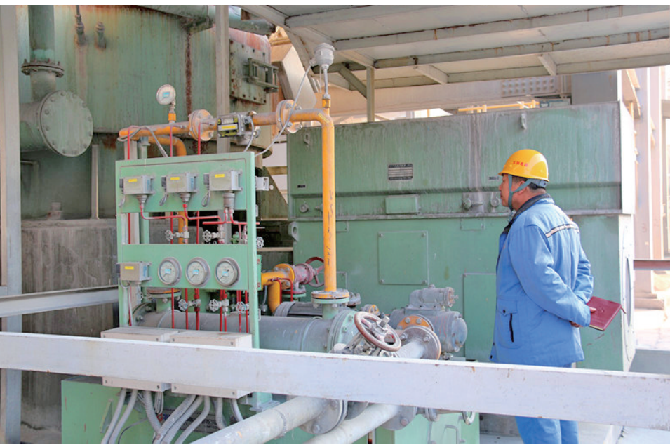
为确保设备正常运转、生产安全顺行,太钢鑫磊公司加强设备管理,认真点检维护,实现了设备系统的稳定运行。因为设备系统负责人深入现场检查设备运行情况。 于石 摄
