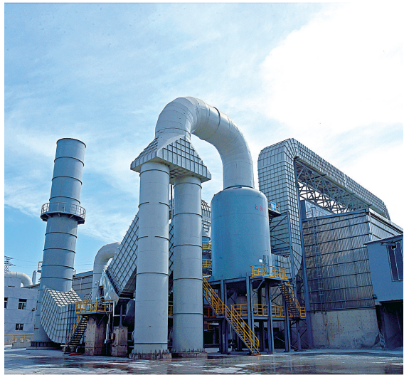
图为不锈钢渣处理除尘系统。王旭宏 摄
