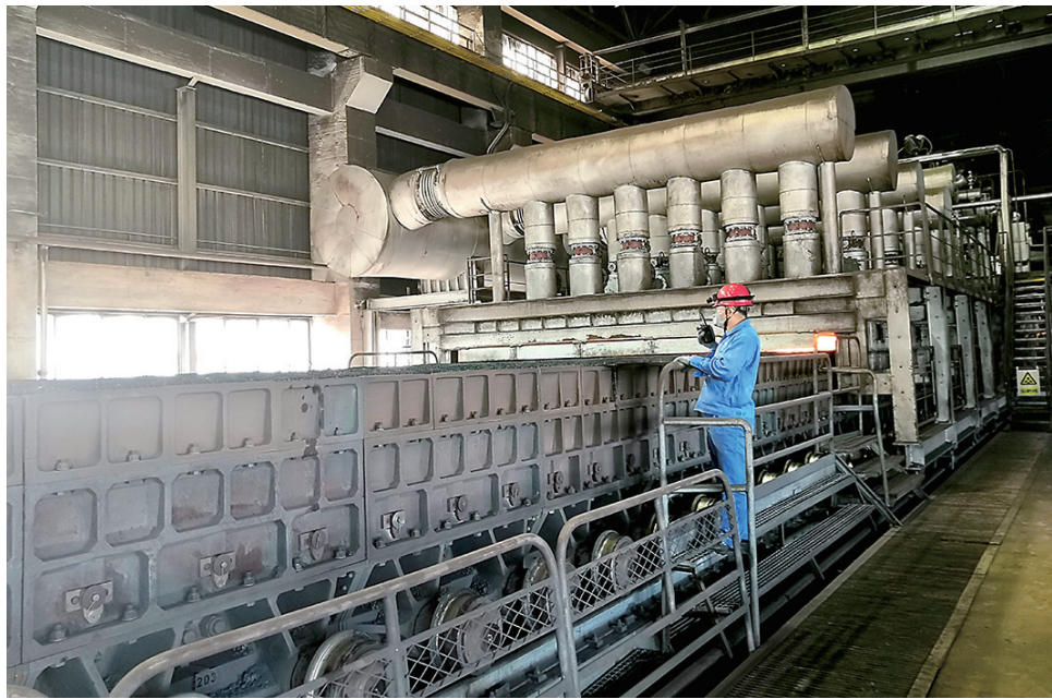
炼铁厂四烧作业区克服高温多雨的影响,科学组织生产,7月份生产创历史同期最好水平,为确保五高炉大修顺利进行、圆满完成保产任务交上了一份满意的答卷。图为岗位人员正在观察烧结机生产情况。
