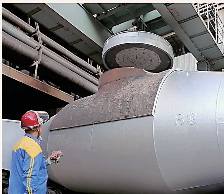
近日,物流中心组织专业技术人员开展鱼雷罐加盖试验,检验设备性能,为鱼雷罐加盖投入使用做好前期准备。鱼雷罐加盖装置投入使用后,将有效减少鱼雷罐口烟尘排放,助力公司绿色发展。
