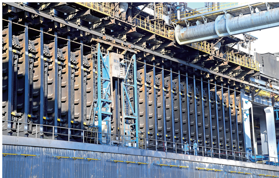
太钢焦化厂通过实施焦炉烟气脱硫脱硝、酚氰污水池封闭、全火车运煤等一揽子环保项目,使焦化工序环保设施配置达到了同行业一流水平,实现全流程超低排放常态运行。图为焦炉生产洁净有序。 王旭宏 摄
