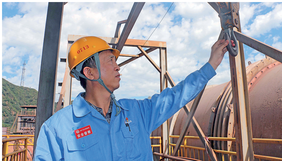
太钢代县矿业公司牢固树立隐患就是事故的观念,坚决克服麻痹思想、侥幸心理和松劲情绪,强化安全风险防控和隐患排查整治,确保安全生产形势持续稳定,以优异成绩迎接建党100周年。图为职工正在精细检查电葫芦钩头锁片是否完好。 王振华 摄
