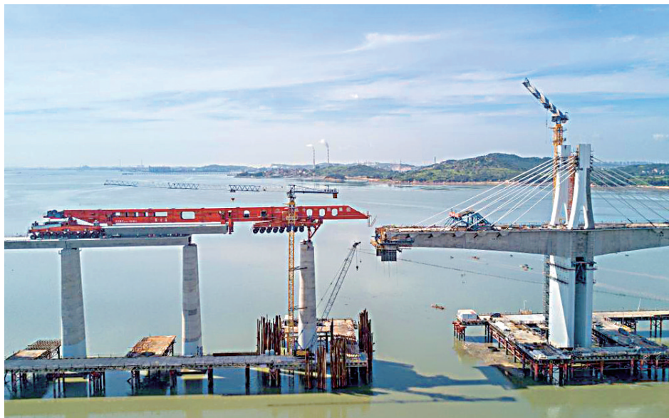
7月11日,在新建福厦铁路湄洲湾跨海大桥建设现场,中铁十一局工人协同“昆仑号”千吨级运架一体机架设该线路最后一孔40米箱梁(无人机照片)。
