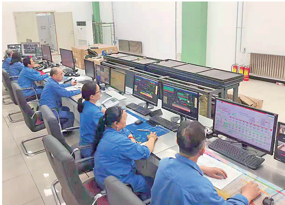
太钢炼铁厂铁前智能物流系统实现了所有物料全部进仓,可对三座高炉、两个烧结原燃料统一调度与运输,结束了汽车倒搬高炉原燃料的历史,从根本上改善了现场环境。图为集控室员工正在精心操作。
