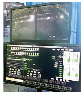
改造后的中控操作画面
