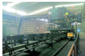
干煤棚内堆料机正在无人作业
