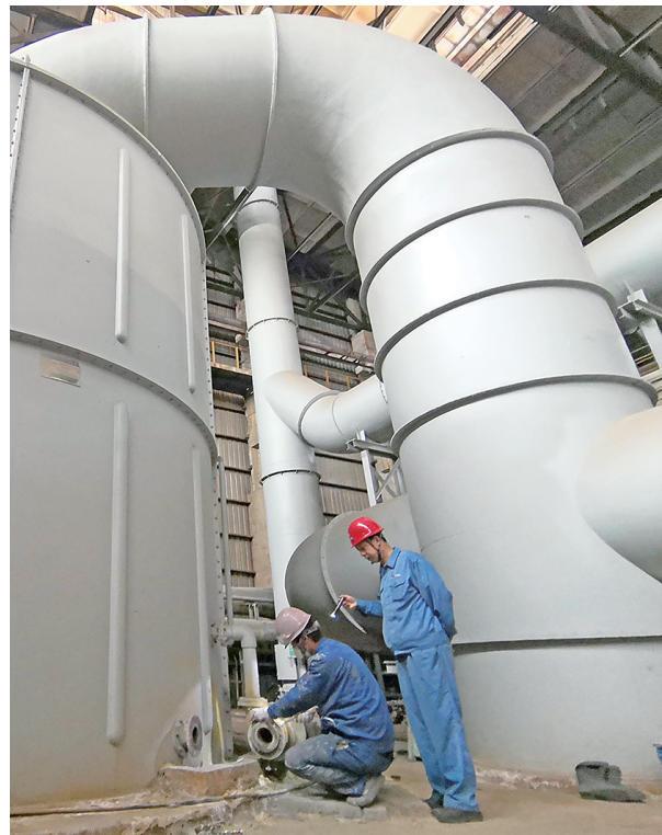
围绕中国宝武太钢不锈“碳达峰、碳中和”环保理念,太钢型材厂积极推动环境保护工作,通过培训不断提高员工生态环境保护意识,提升岗位标准化操作水平,确保设备环保功能精度。图为维护人员对酸雾净化塔环保设备进行检修维护。 冯秀娟 摄
