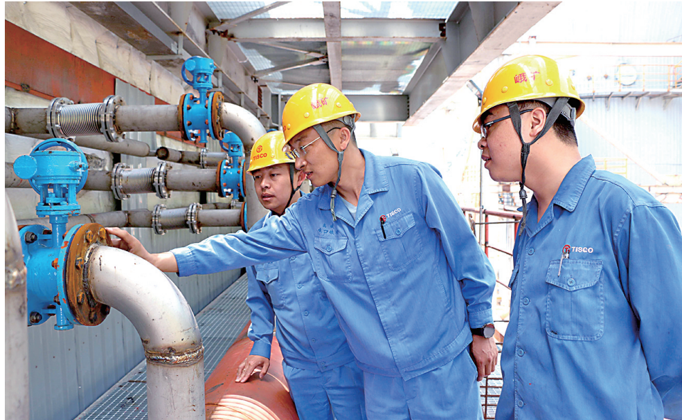
为确保新建设备各项功能达标,太钢代县矿业公司紧密跟踪脱硝工程建设情况,组织专人对工程进行联合检查验收,及时发现问题缺陷并整改。图为专业人员正在现场进行检查。 刘艳云 摄
