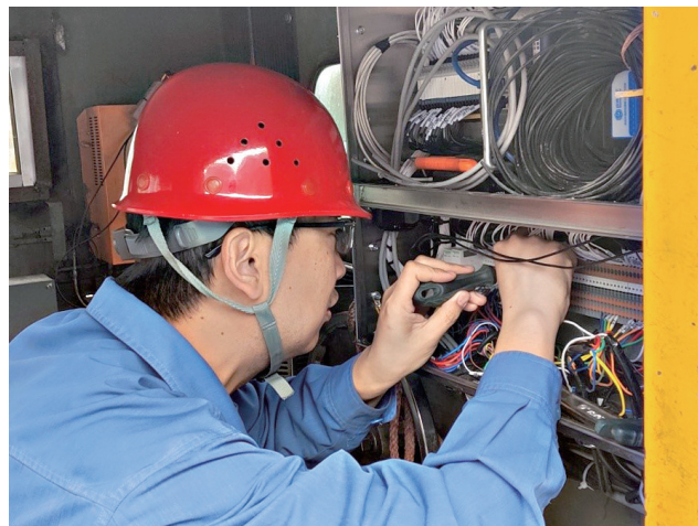
近日,信自公司自动化事业部技术人员完成了代县矿业公司电机车自动运行系统升级改造,实现了自动控制和远程控制相结合及电机车无人驾驶,极大地提升了系统连续生产能力和安全运行水平。图为技术人员对电机车自动运行防护控制单元接线。刘佳媛 摄
