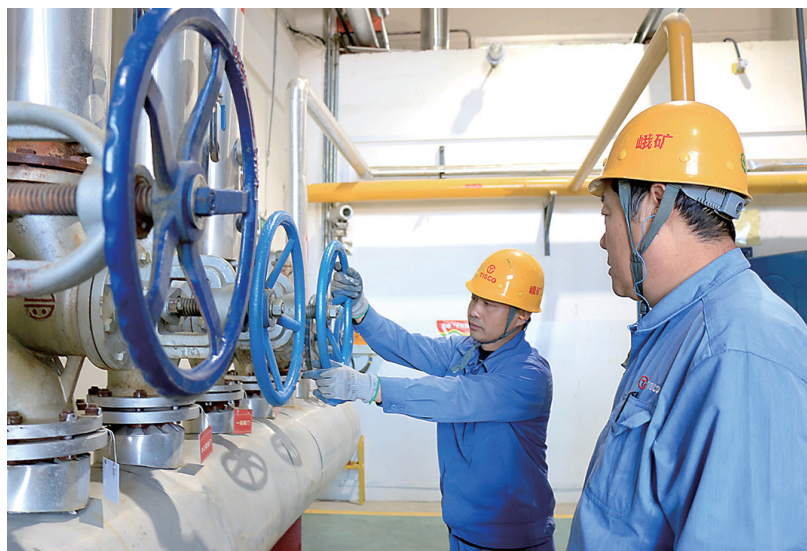
太钢代县矿业公司积极组织入冬供暖送气,安排锅炉生产调试、岗位培训,落实故障处置、协调保障措施,为平稳供气打下坚实基础。
