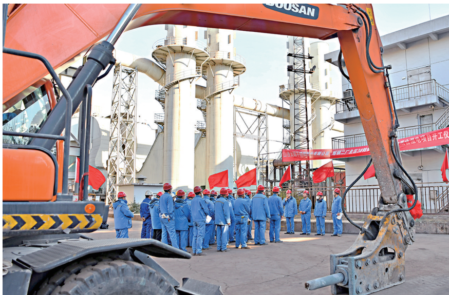
近日,太钢炼钢二厂对转炉一次干法除尘系统进行升级改造,项目实施后,将有效提高转炉一次除尘效果,降低污染物排放量,为打好污染防治攻坚战,实现绿色低碳发展奠定良好基础。图为项目开工仪式。
