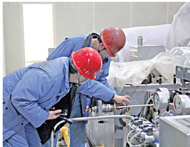
太钢煤气锅炉升级改造项目经过9个月的高效运转进入消缺阶段,太钢能源动力总厂利用一周时间,在严密的安全措施下,对汽轮机系统和锅炉系统进行精心维护,提高设备的功能精度和高质量运行。该项目作为太钢提升余热余热、二次能源利用效率,实现低碳发展的重点项目,运行中热效率提升了50%,极大地提高了铁前工序余热回收利用水平。图为该厂技术人员正在对机组高压缸设备进行消缺确认。郭红梅 摄
