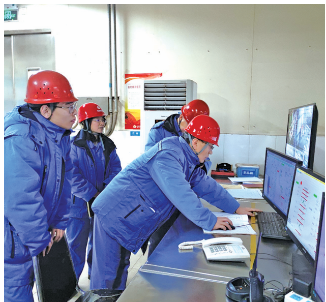
为保证太钢铁区智控中心建设基础自动化升级改造项目成功上线,信自公司自动化事业部与炼铁厂全面统筹部署各项升级改造任务,利用检修时间做系统上线准备工作,优化和提升太钢铁区智慧系统的集中监控能力。图为相关人员对六高炉水渣及余热回收系统进行优化整合。 许全喜 摄
