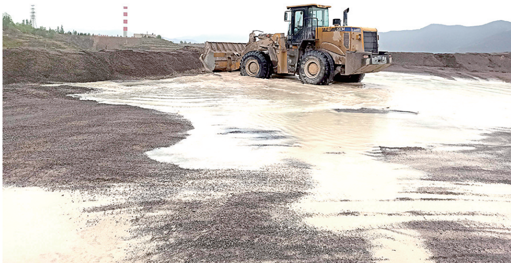
在汛期来临之际,太钢鑫磊公司由支委牵头,组织党员职工对采矿、破碎、回转窑区域的高位水池、边坡等防洪防汛重点部位开展防汛检查,确保安全生产顺利进行。图为生产作业区对废堆场的积水进行疏通。
