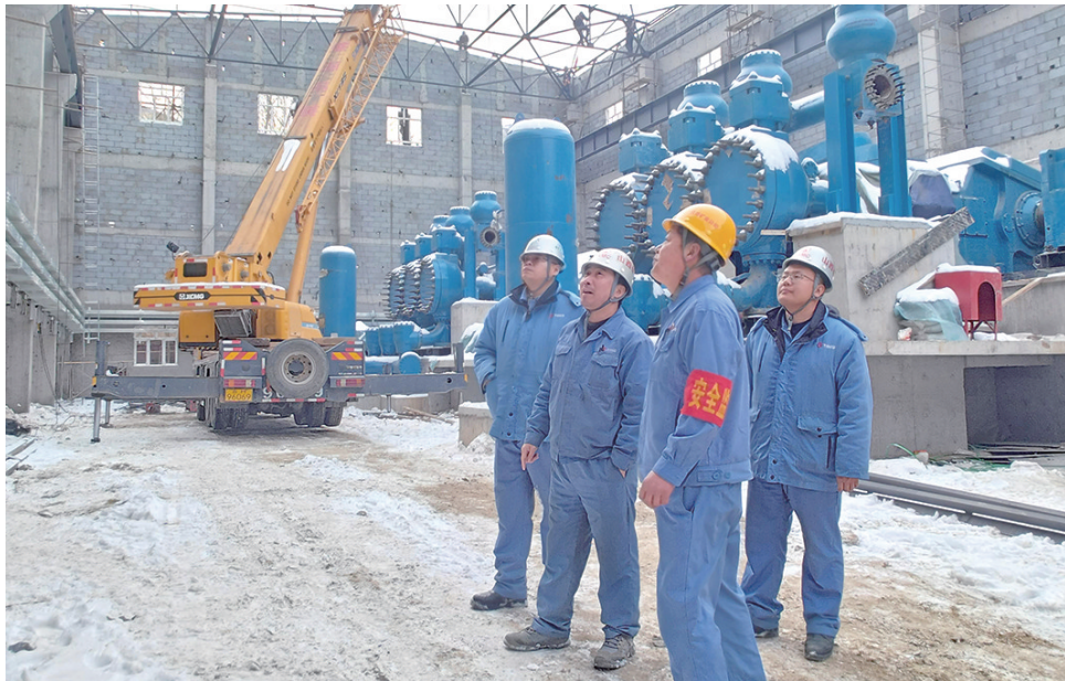
太钢代县矿业公司新建化咀沟尾矿库工程进入倒计时,全体人员紧盯时间节点,放弃节假日休息,全力以赴、只争朝夕,以高度的责任感和敬业精神保证工程能够顺利完成。图为尾矿输送泵站施工现场,管理及施工人员现场督查。刘艳云 摄
